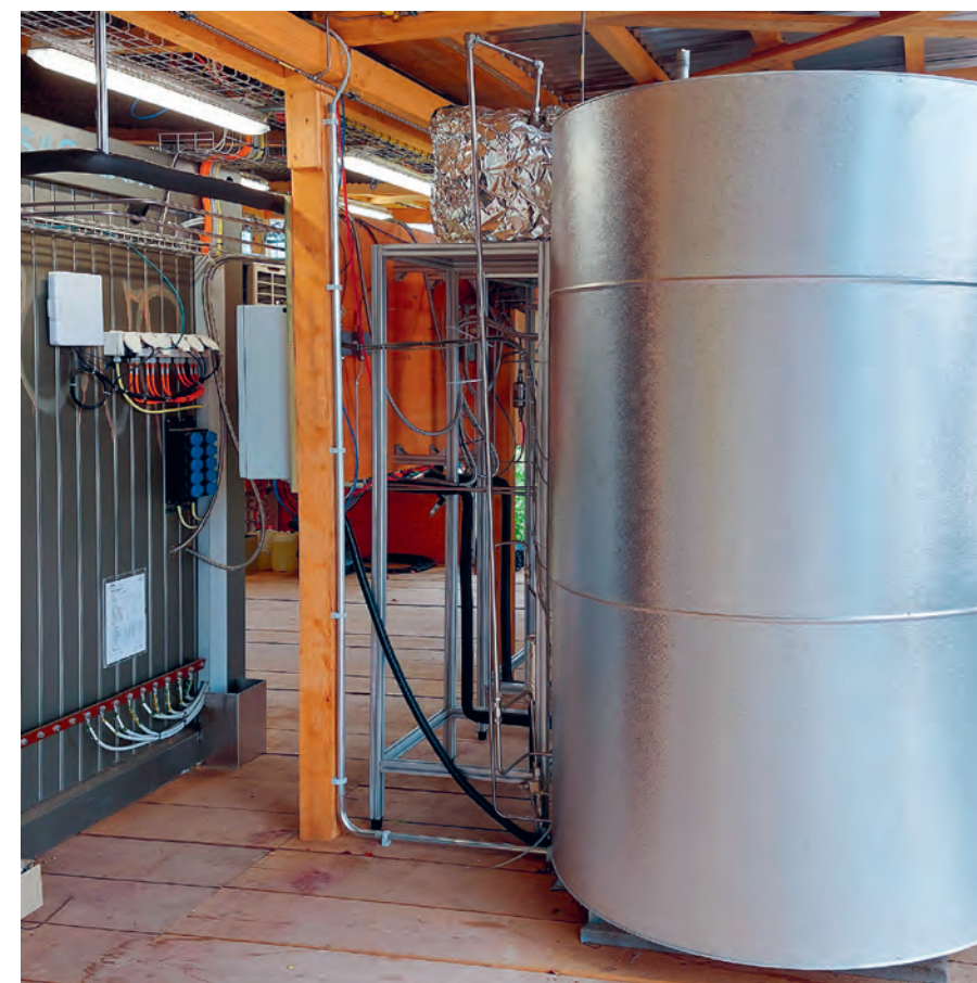
Pilotanlage am Campus Höggerberg Die technische Machbarkeit der Speichertechnologie haben die Forschenden anhand einer Pilotanlage am Campus Höggerberg demonstriert. Diese besteht aus drei 1,4 Kubikmeter grossen Edelstahlkesseln, die die Forschenden mit jeweils zwei bis drei Tonnen am Markt erhältlichem, unbehandeltem Eisenerz gefüllt haben.
