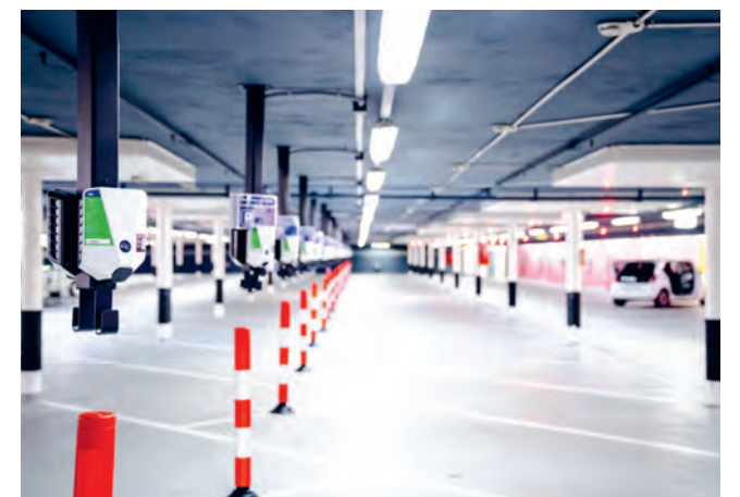
Je nach Standort eines Parkplatzes wird die Ladestation an der Wand (Wallbox) montiert oder aber von der Decke abgehängt.
